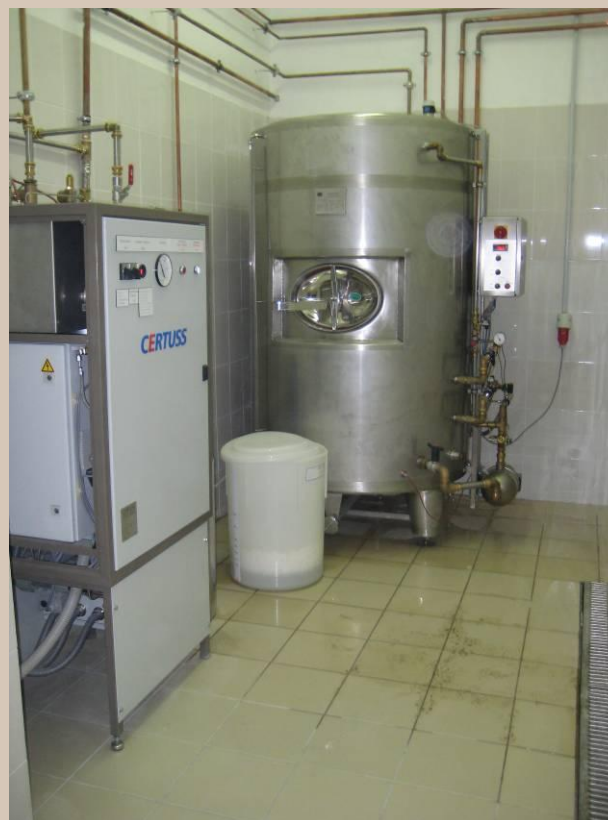
Wytwornica pary i zbiornik wody gorącej.
