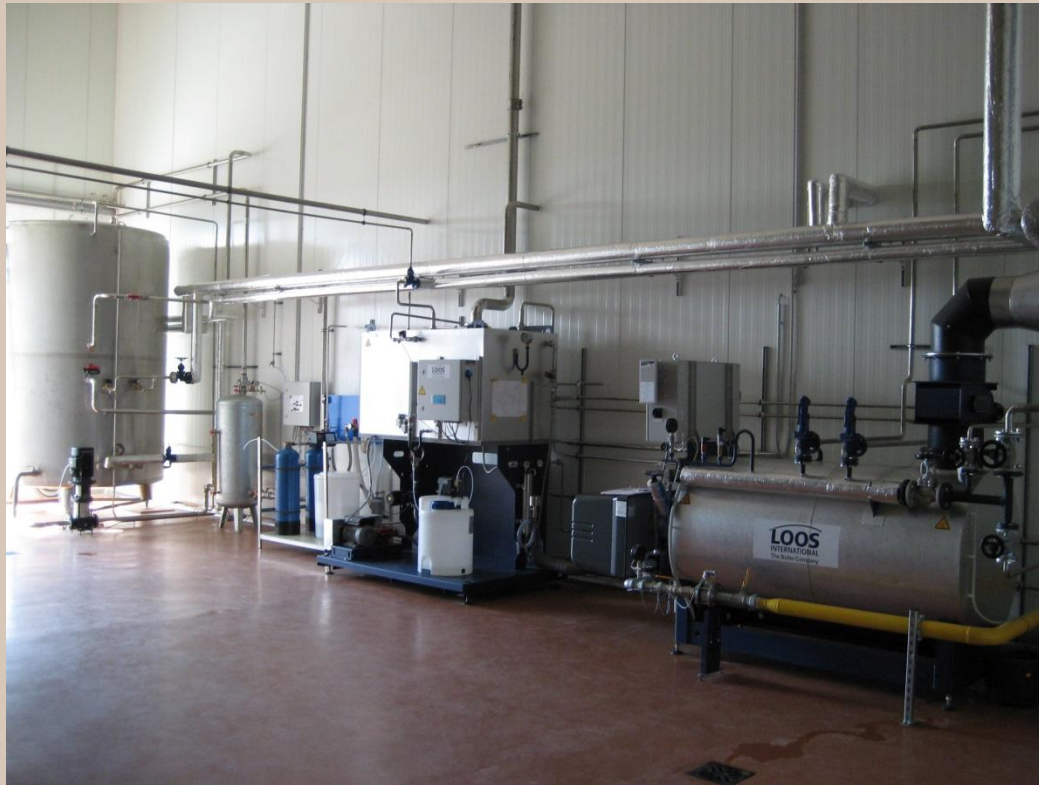
Technika (uzdatnianie wody, generator pary)
